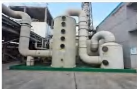
污水站废气处理装置
