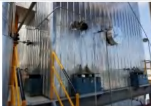
甲醇制氢废气处理设施
