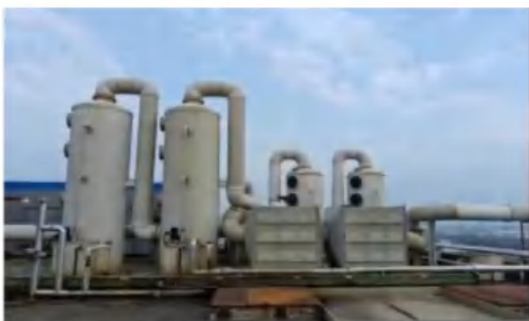
邻氯甲苯罐区废气处理装置
