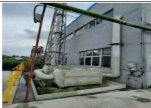
危废间废气处理装置
