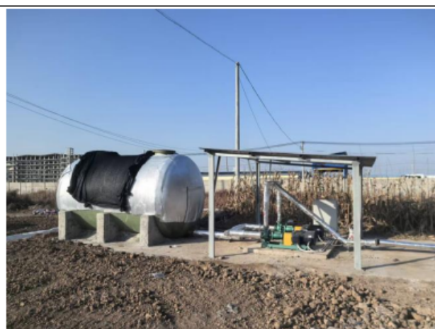
次氯酸钠（除臭剂）加药装置
