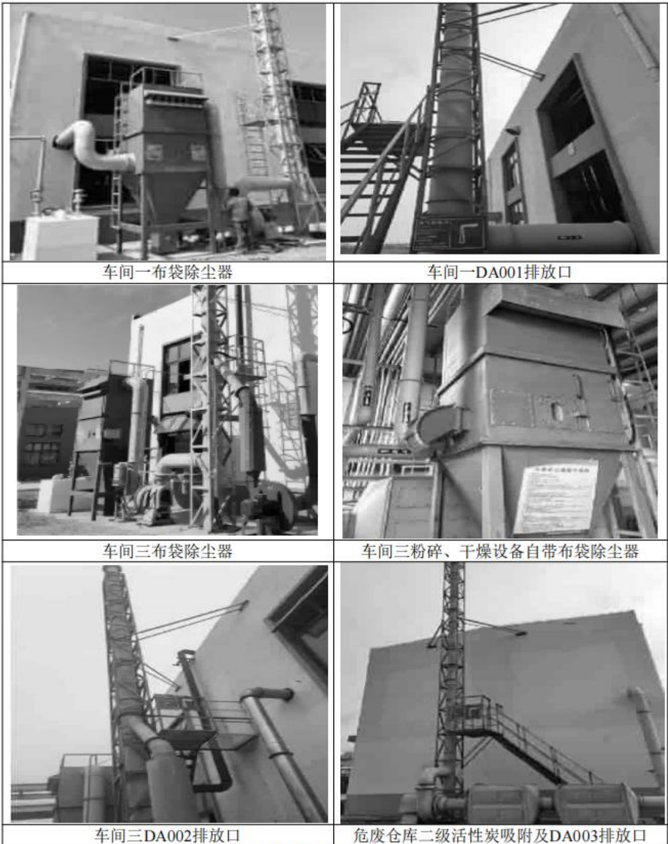
图3.2.1-3 现有已建工程废气处理设施
