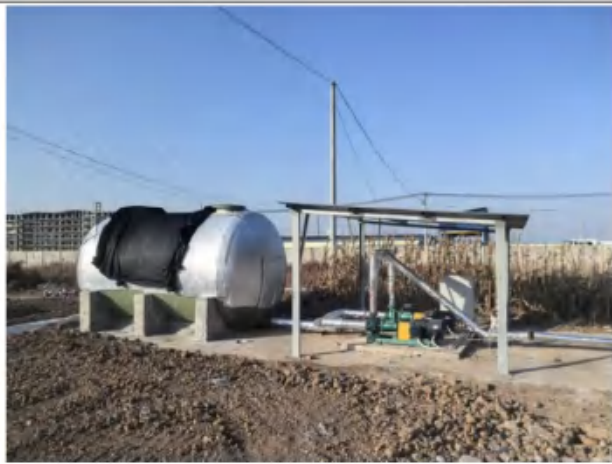
次氯酸钠（除臭剂）加药装置
