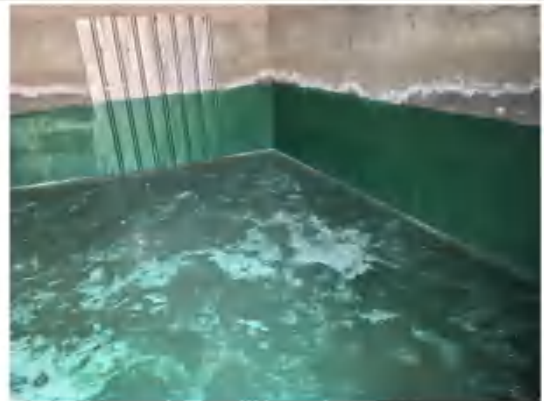
危废暂存间重点防渗
