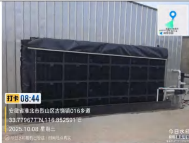
猪舍废气除臭墙
