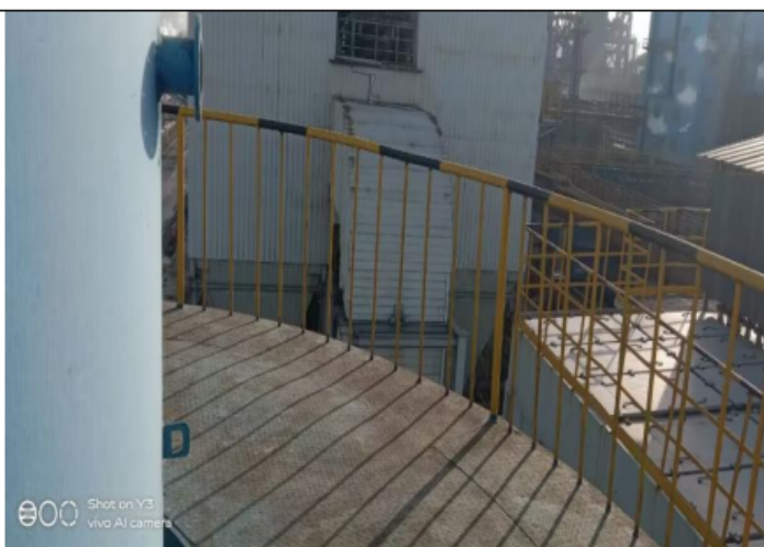
采样口及采样平台
