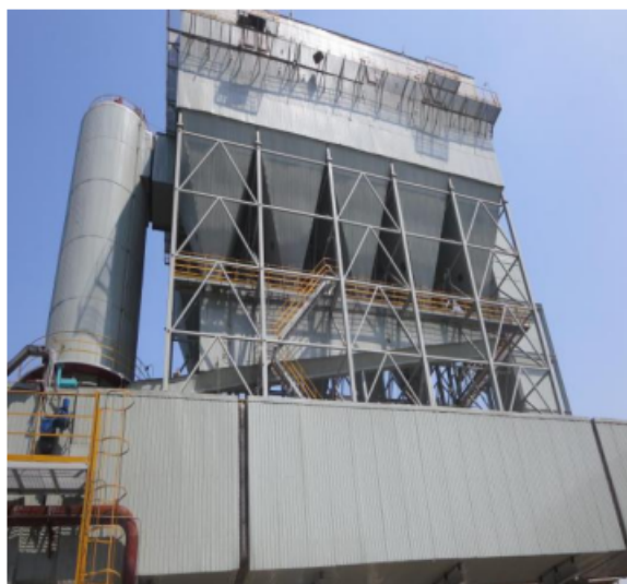
焦炉烟囱脱硫脱硝装置
