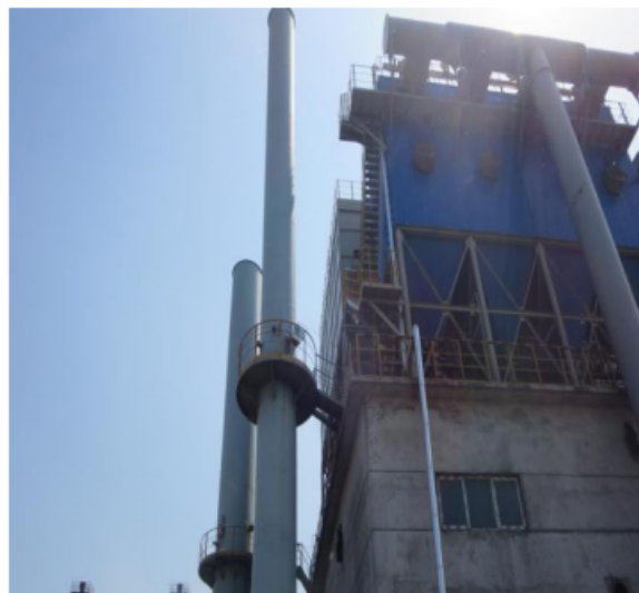
装煤地面除尘站
