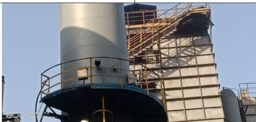
采样口及采样平台
