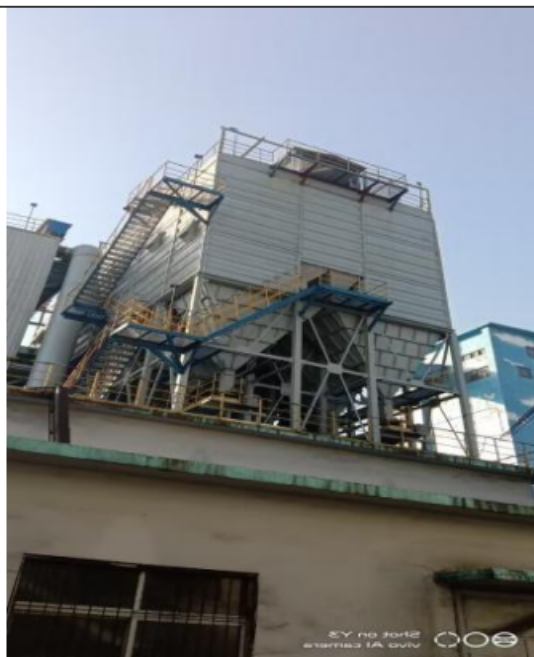
覆膜袋式除尘器
