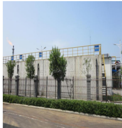
循环排污水深度处理装置
