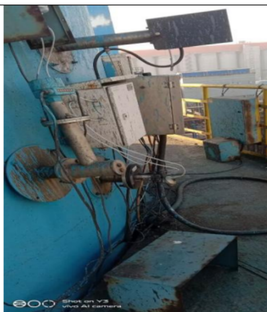
采样口及采样平台
