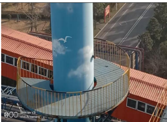
采样口及采样平台
