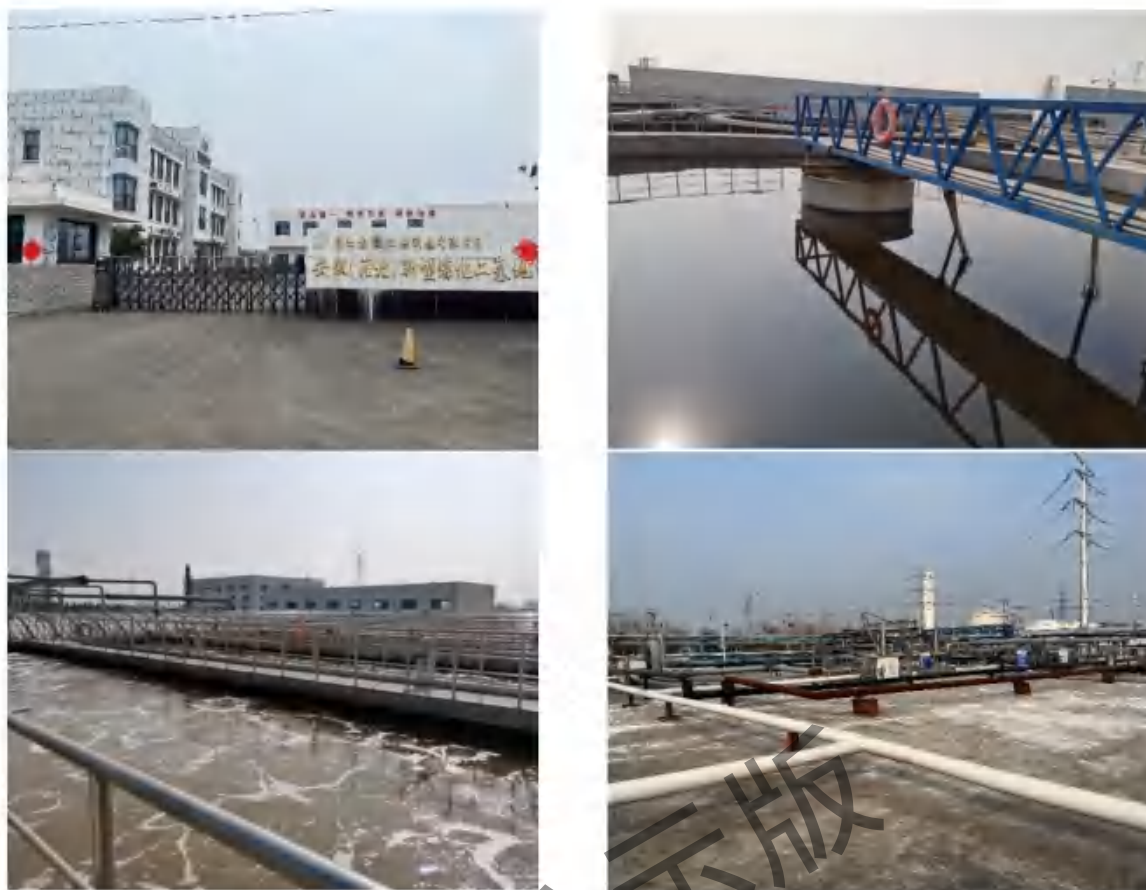
图 5.2-2 园区污水处理厂（鑫远）现场图片
