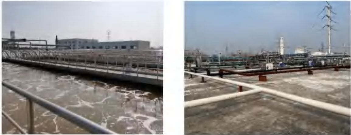
图 6.2-11 园区污水处理厂（鑫远）现场图片
