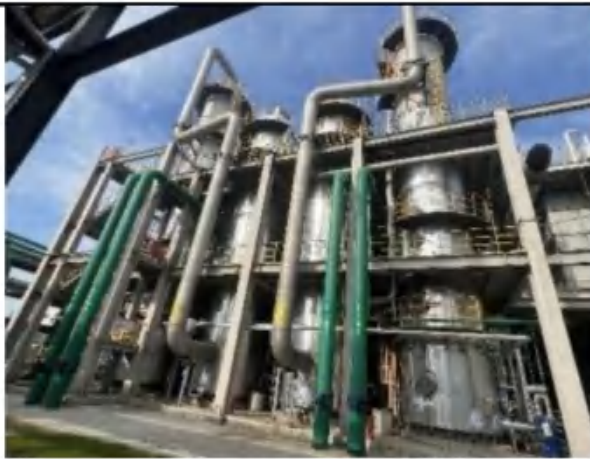
甲醛工艺废气收集设施
