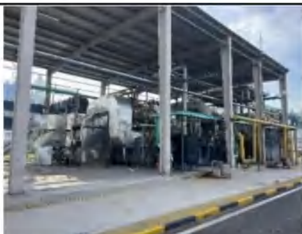
尾气焚烧锅炉
