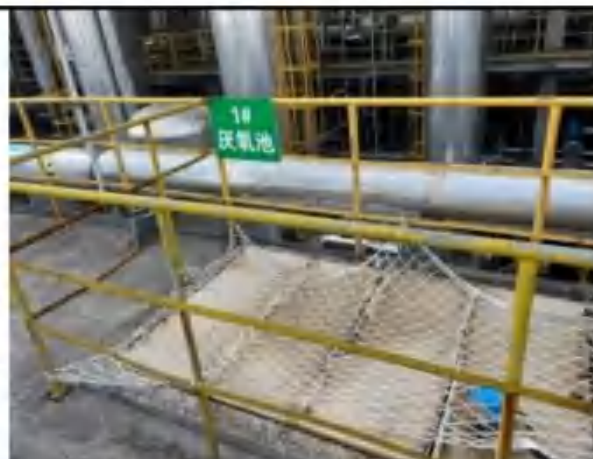
生物滤床设施
