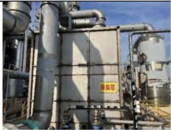
污水处理站废气收集设施
